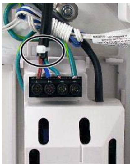
Figura 2.3 Braçadeiras para cabos da rede eléctrica até à Fonte de Alimentação
