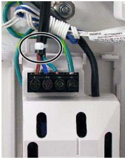
Bild 2.3 Kabelbinder für Netzstromleitungen zum Netzteil
